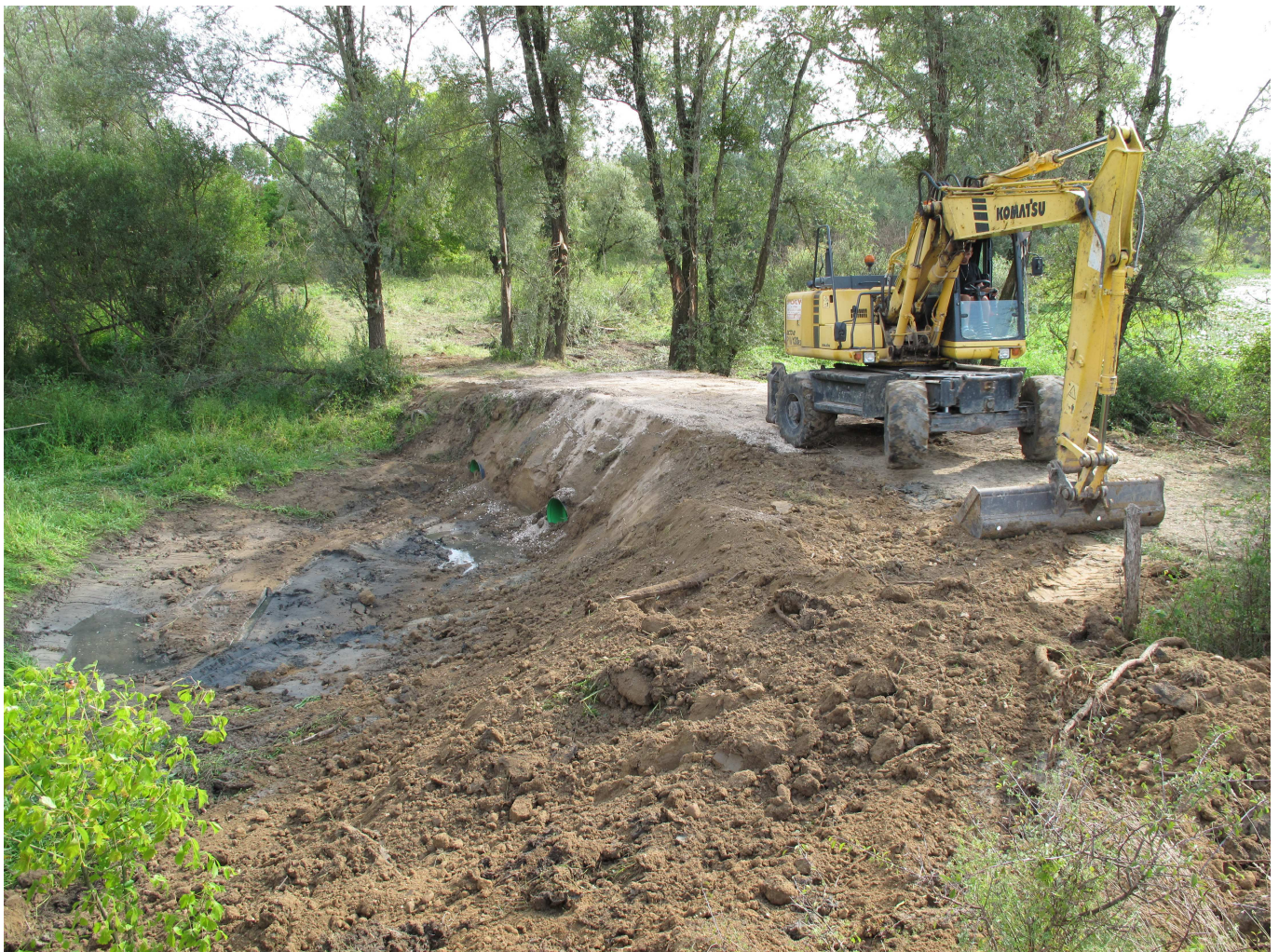
Photographie 15. Exemple d'un franchissement réalisé sur le bras mort de Sur l'eau à Lay-sur-le-Doubs (largeur 6 mètres, buse de 600 pour 6 mètres de longs)
