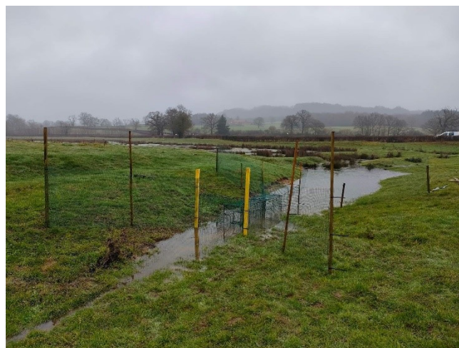
NASSES POSEES DANS LE FOSSE DE CONNEXION ENTRE LA ZONE HUMIDE DES CHAINTRES ET L'ARROUX
